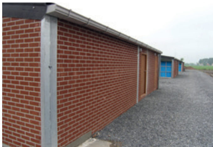
Er werden op de zeugenstal drie luchtfilters geplaatst, drie eenheden van 60.000 m². Ook de biggenbatterijen en de vleesvarkensstallen werden van de nodige overdruk-units voorzien.
