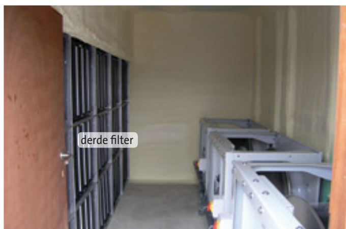
Daarna werden de turbines gemonteerd die de buitenlucht binnentrekken; en tot slot vangt een derde filter, een F9 volgens Europese normen, meer dan 98 procent van de resterende eventuele viruspartikels uit de lucht. Alle filters samen houden zo 99,9 procent van de viruspartikels uit de lucht.
