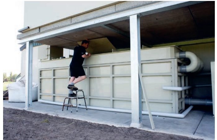
De ILVO-bevindingen leren dat een nauwkeurige opvolging en tijdig onderhoud van het luchtbehandelingsysteem noodzakelijk is om een goede werking te verzekeren.
